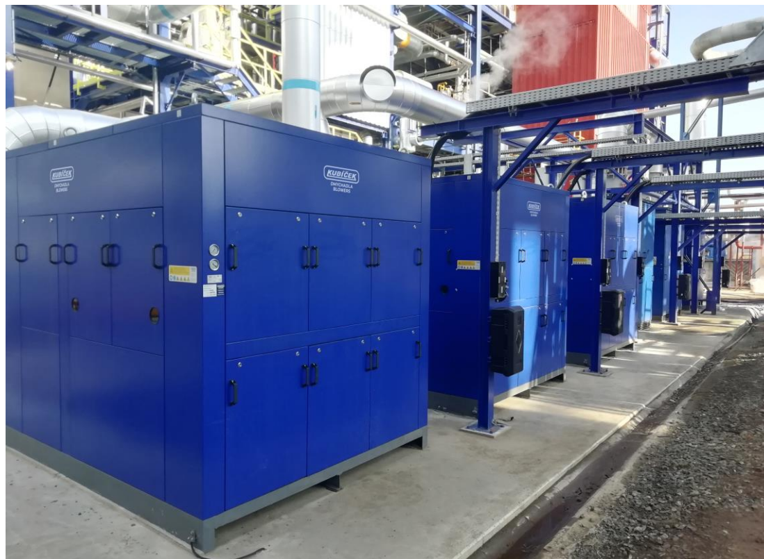
Unidades de sopladores ROOTs - Planta química Draslovka Kolín (CZ)
