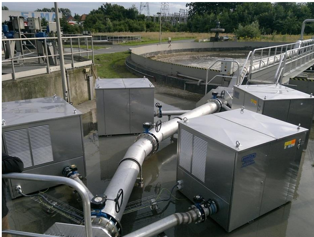
Unidades de sopladores ROOTs - Plantas de tratamiento de aguas residuales (PTAR) Burcht (Antwerpen, Belgium)
